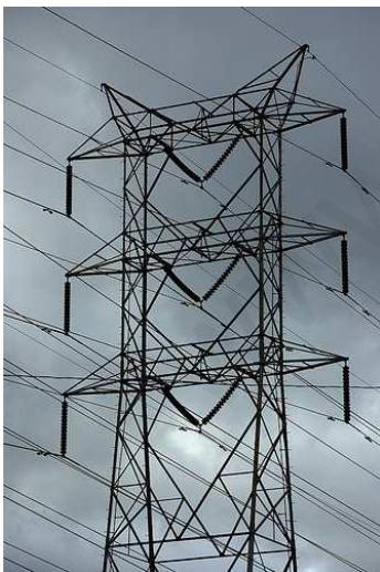
Torre alta tensión.
