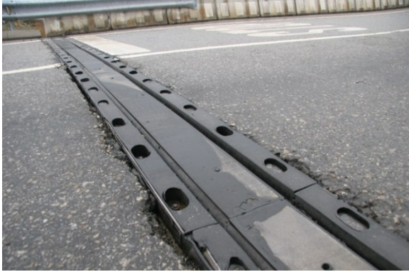
Junta de dilatación
